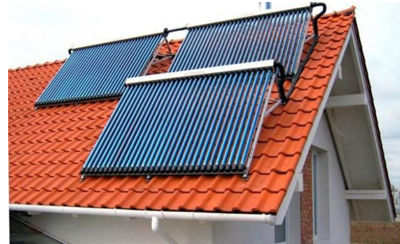
Теплоснабжение коттеджа с использованием плоских солнечных коллекторов
